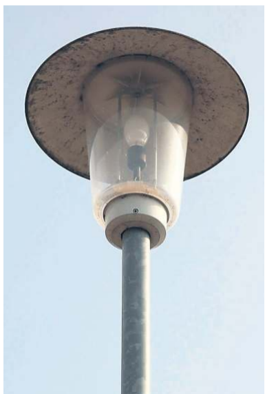
In Gransee sorgen insgesamt 20 Lampentypen für Licht. FOTO: UH
