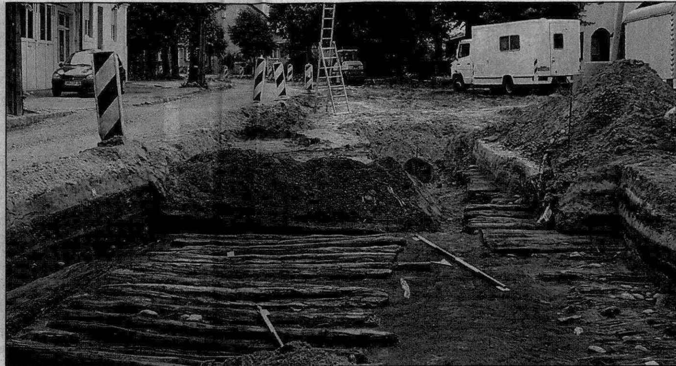
Unter der Berliner Straße, an der derzeit gebaut wird, fanden die Archäologen einen alten Knüppeldamm. Wahrscheinlich stammt er aus dem 18. Jahrhundert. Derzeit werden Holzproben genommen, um das Alter genau zu bestimmen. FOTOS: SCHLEY
