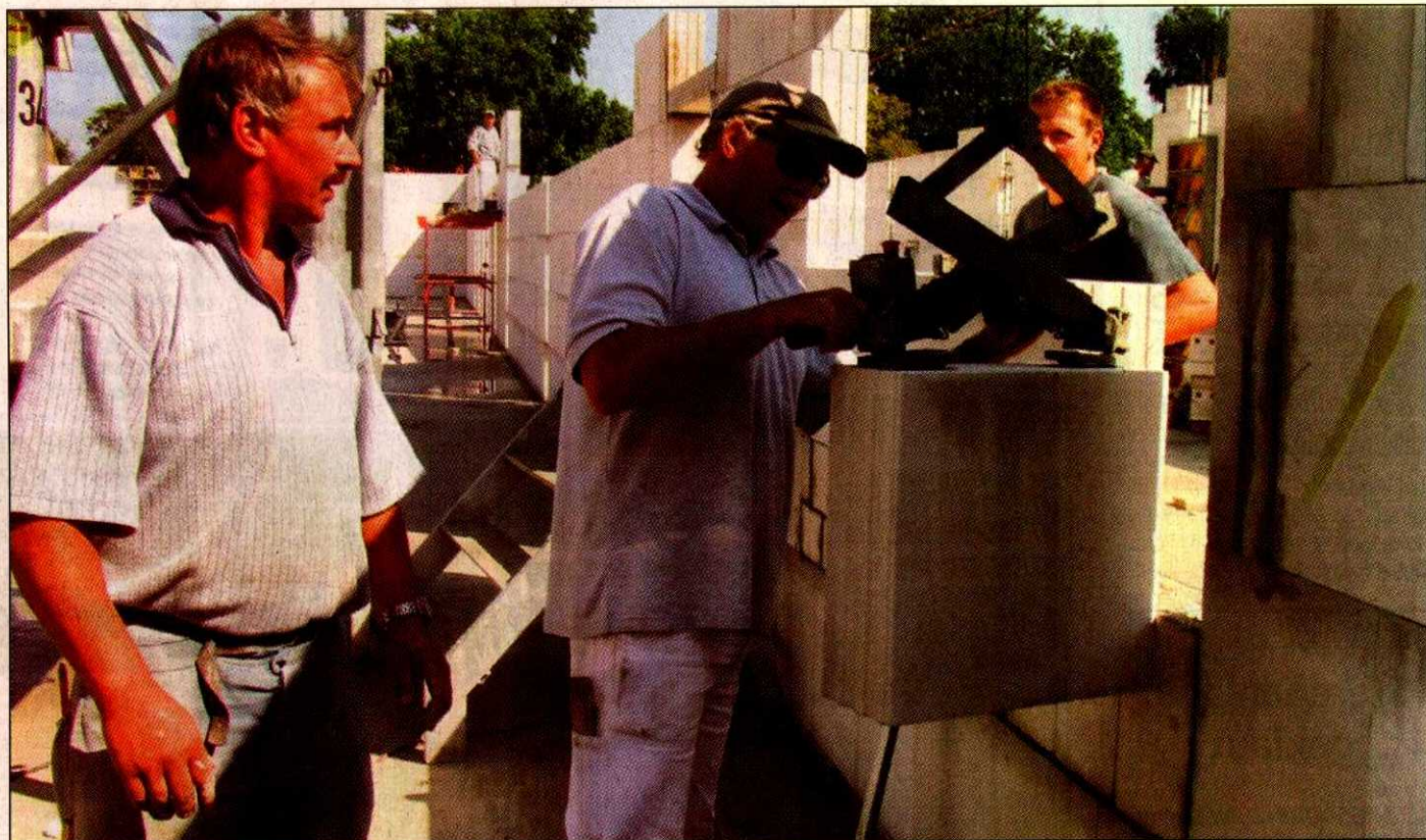
Noch arbeiten Gerd Oelke (links), Manfred Ebermann (Mitte) und ihr Polier Mike Göbel von der Firma Koopmeiners aus Neustadt (Dosse) am Rohbau des neuen Mühlenbecker Aldi-Marktes. Fotos (2): Zamecki
