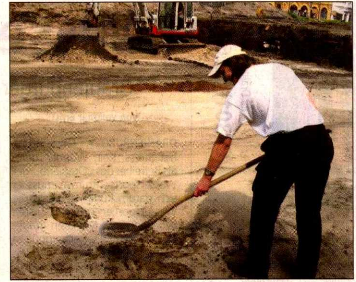
Unter dem Schwemmsand in dieser Baugrube am Fischerplatz vermutet Archäologin Elisabeth Kirsch eventuell noch bedeutende Funde aus dem alten Oranienburg. Fotos (4): Brennecke
