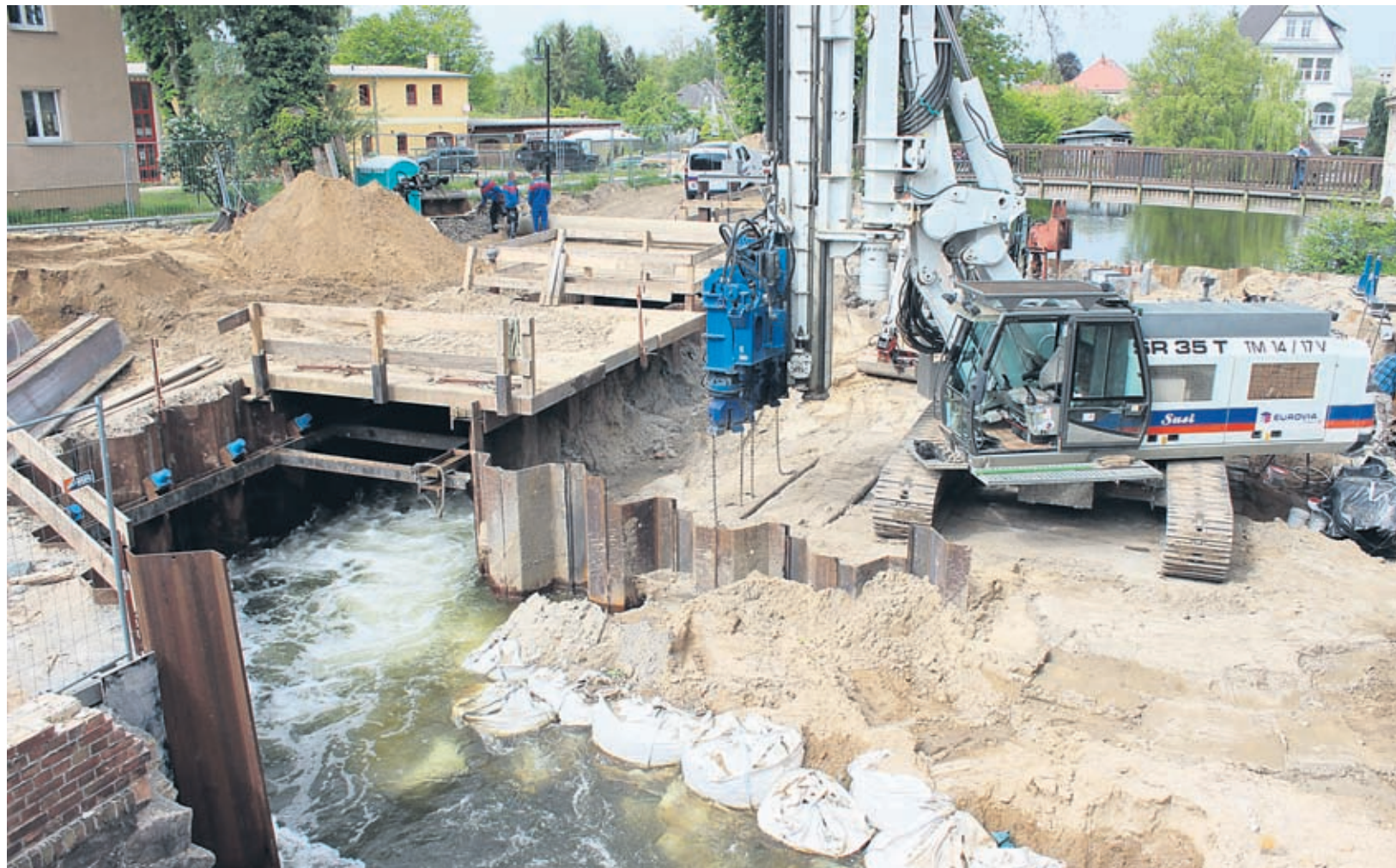
Die Dauerbaustelle in Fürstenberg: Im Herbst 2014 sollte sie fertig sein, nun dauert es voraussichtlich bis Dezember dieses Jahres. FOTO: BLUMBERG
